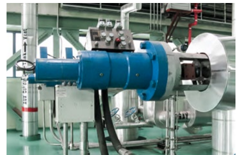
Hydraulikantrieb für Turbinen-Bypass-Ventil, mit Regelfunktion über Proportionalventil und 3-fach Sicherheitsauslösung der Schnellöffnungsfunktion.
